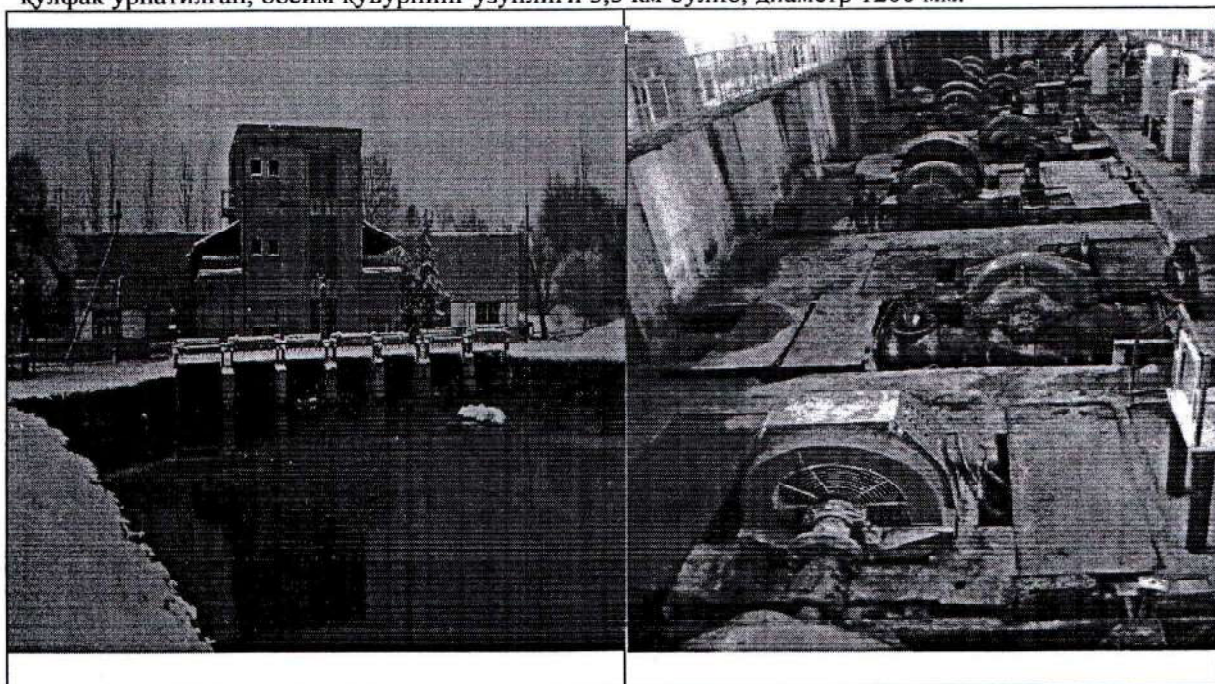
2-расм. Пахтакор насос станцияси
