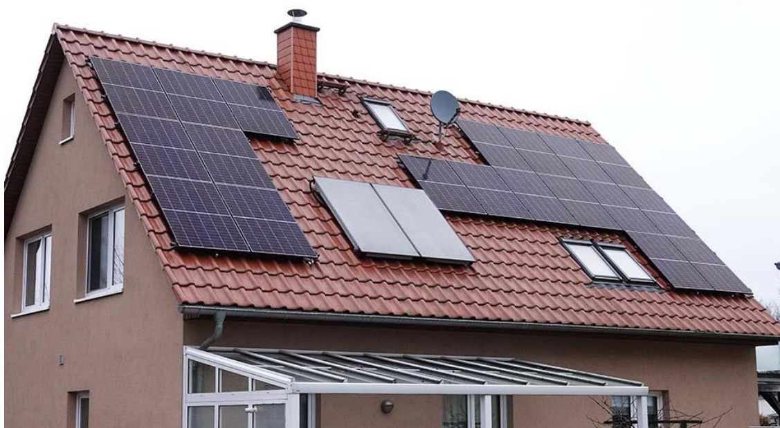
Рис. 1. Солнечные панели на здании
